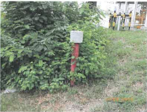
รูปที่ 2-15 Monitoring Well เขตอุตสาหกรรมทั่วไป ระยะที่ 1 บ่อ 3
